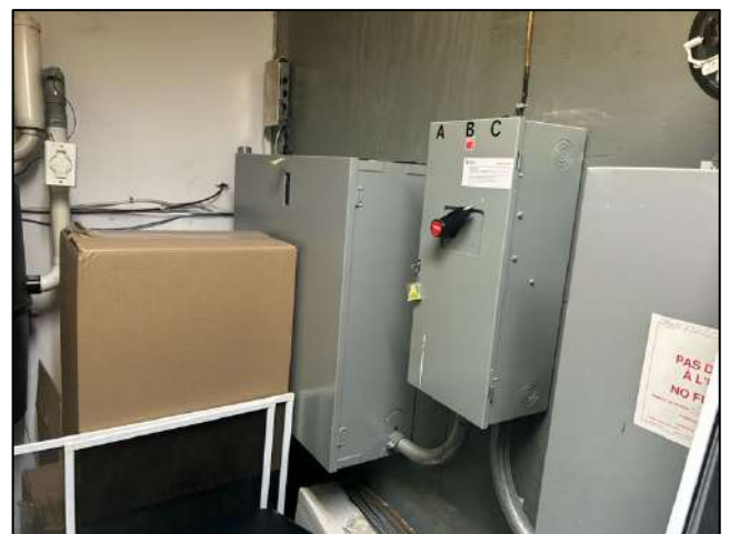
Salle électrique (demi sous-sol)
