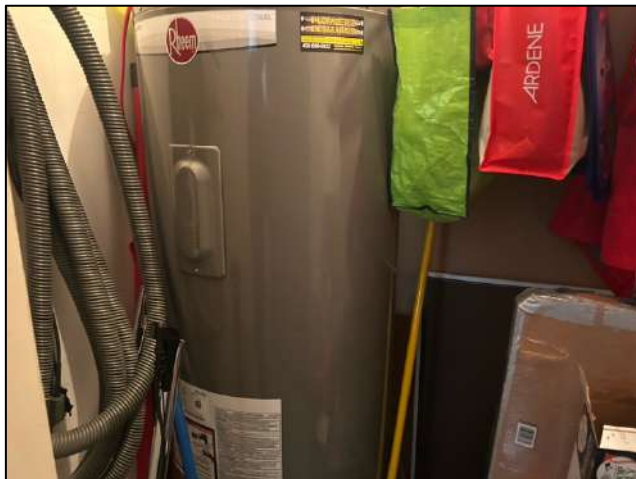
Réservoir d'eau chaude (demi sous-sol)
