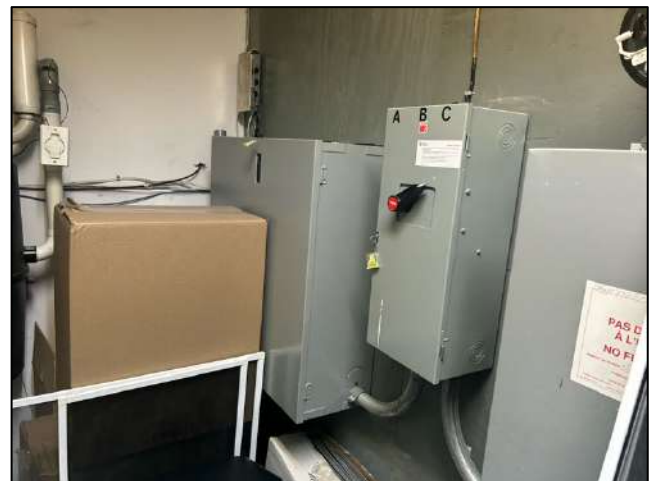
Salle électrique (demi sous-sol)
