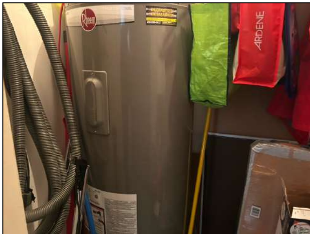
Réservoir d'eau chaude (demi sous-sol)
